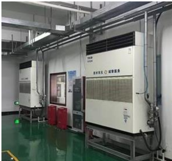
某用户实验室空调机柜
